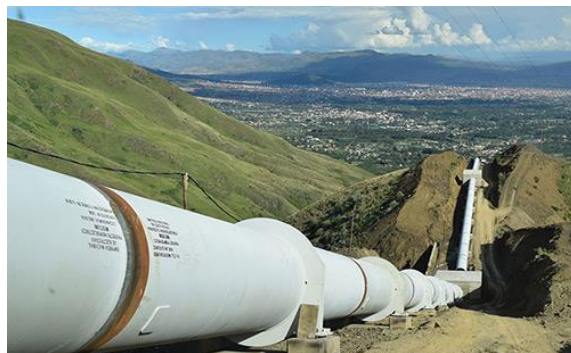
Figura 1.12. Tubería forzada Central Hidroeléctrica Misicuni. Fuente: ENDE Corporation.
