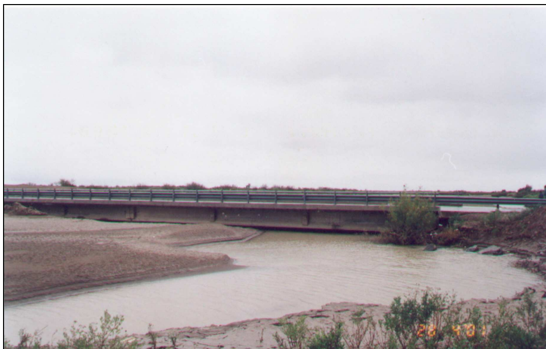
Figura 2.9. Puente del río Mendoza en el sector de Asunción. El embanque producido a inicios del 2001 rellenó unos cuatro metros desde el puente a la base del río y provocó el cambio de curso del río. La dirección de la ruta coincide con el paleocauce 5.
