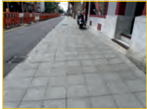
Zu schräger Gehweg (Foto: Sickinger)
