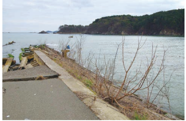
図 15. 津谷川河口付近. 沖合の海中に見える水没したコンクリートのあたりまで砂浜があった。
