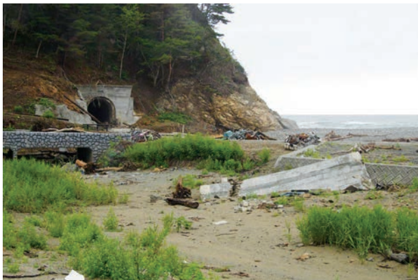
写真 8. 舗装道路は完全に失われている.
