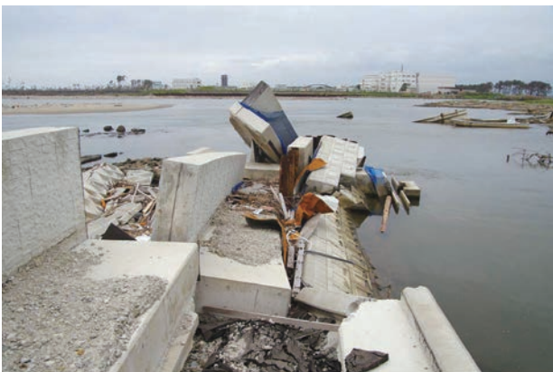
写真 19. 破壊された蒲生干潟南部のえん堤.
