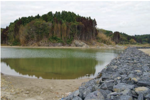
図 13. 小泉海岸 (赤崎海岸). 右側が海. 仮設の堤防が設置されている. 仮設堤防の左側は水田が広がっていたと思われるが水没している。
