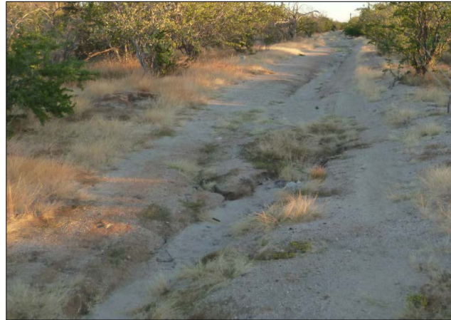
Figura V.5. Erosión hídrica presente en un camino de acceso al predio donde se construirá la subestación.
