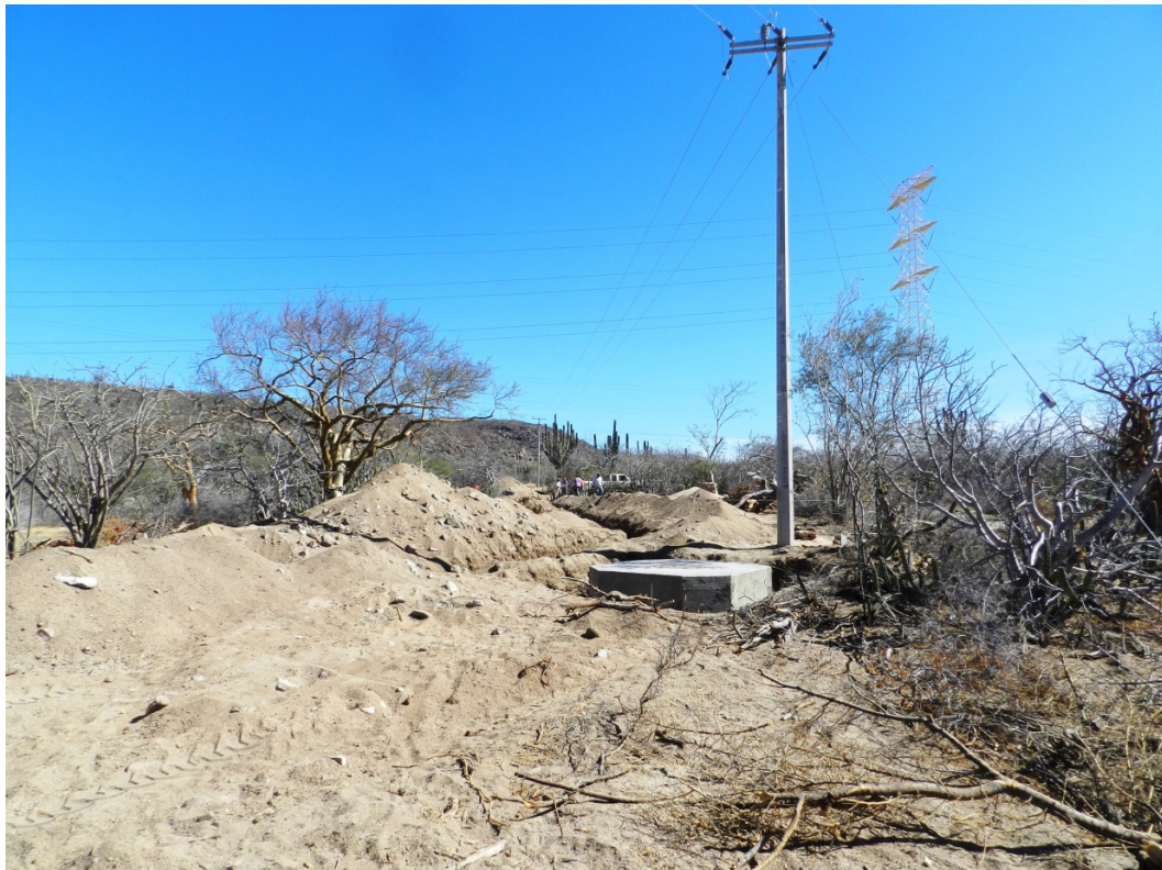
Figura II.3. Construcción del suministro de agua para las instalaciones de la Universidad Tecnológica
