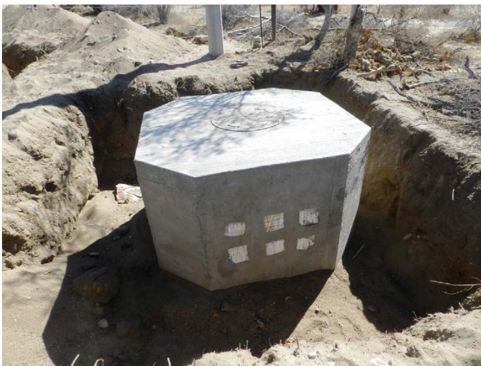
Figura II.8. Registro para el empalme de energía eléctrica subterránea para su suministro a la Universidad Tecnológica.
