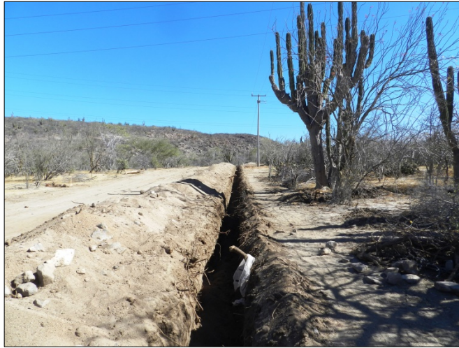
Figura XV.3. Apertura de cepas para el alcantarillado del agua potable a un costado de la S.E. Camino Real Bco. 1 + Mvar.
