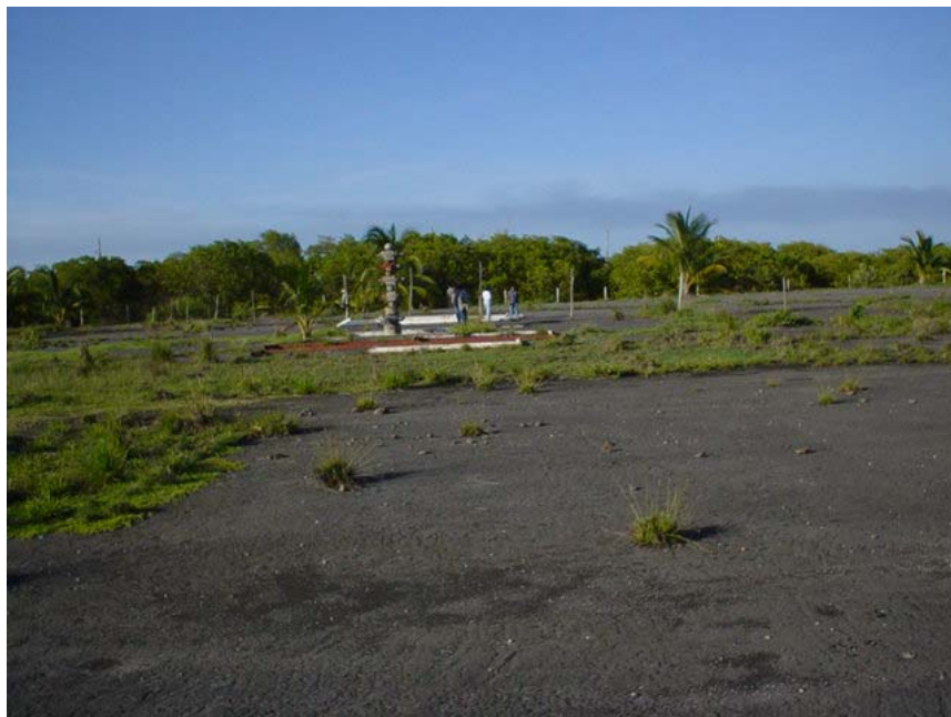
Fotografía 10. Árbol de válvulas del pozo Ribereño 1, se observa la colonización de pastos.
