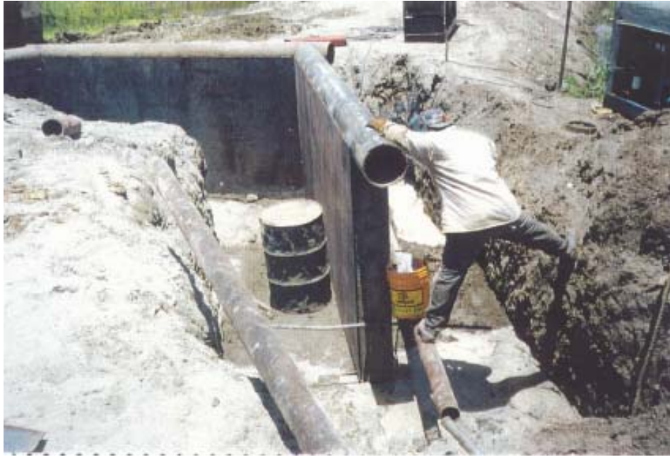
Fotografía 41. Construcción de los estribos del puente y colocación de las placas como muro de contención del puente “pasarela”.
