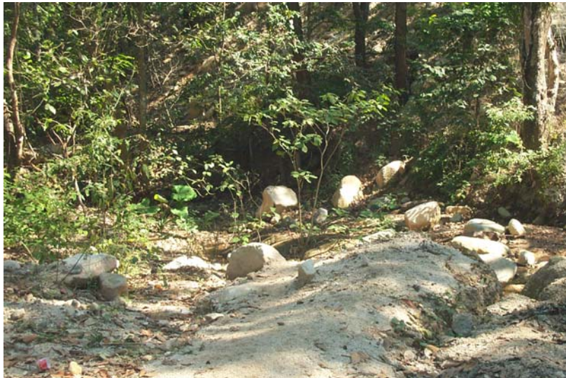
Fotografía 4. Se puede observar que existen partes de la brecha que por sus condiciones ya no son aptas para transitar y que se requiere de obras de drenaje.
