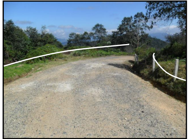
Figura 4.58. Km 2+360, zona del tramo carretero donde la brecha presenta dimensiones adecuadas para la modernización del camino.
