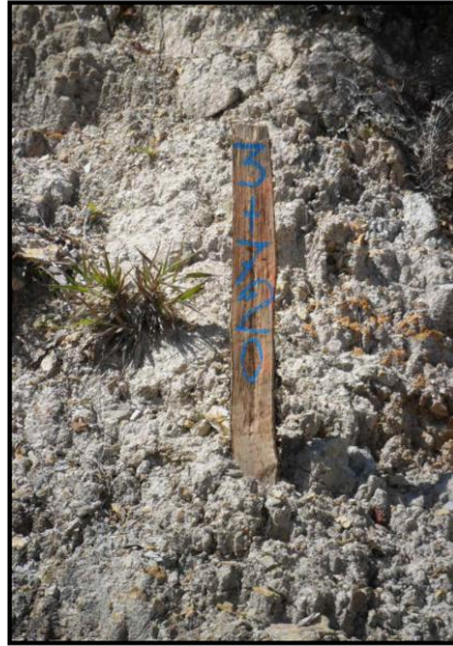
Figura 4.7. Lutitas en el km 3+720, son estructuras poco estables.
