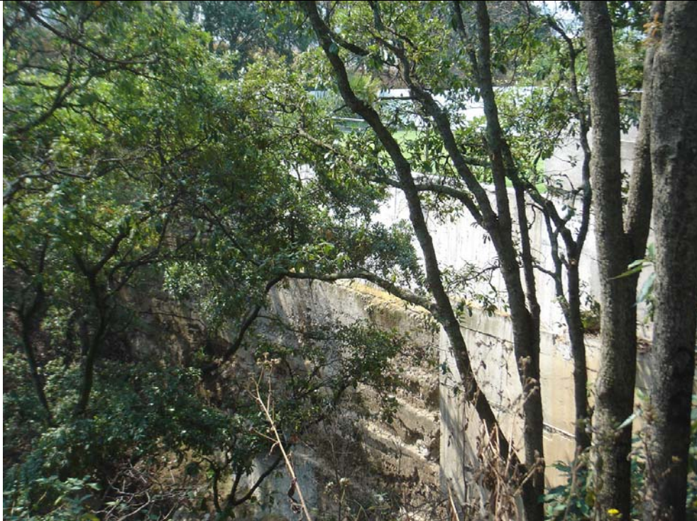
Fotografía 5. Vista del relleno y muro de contención para la construcción de las casas.
