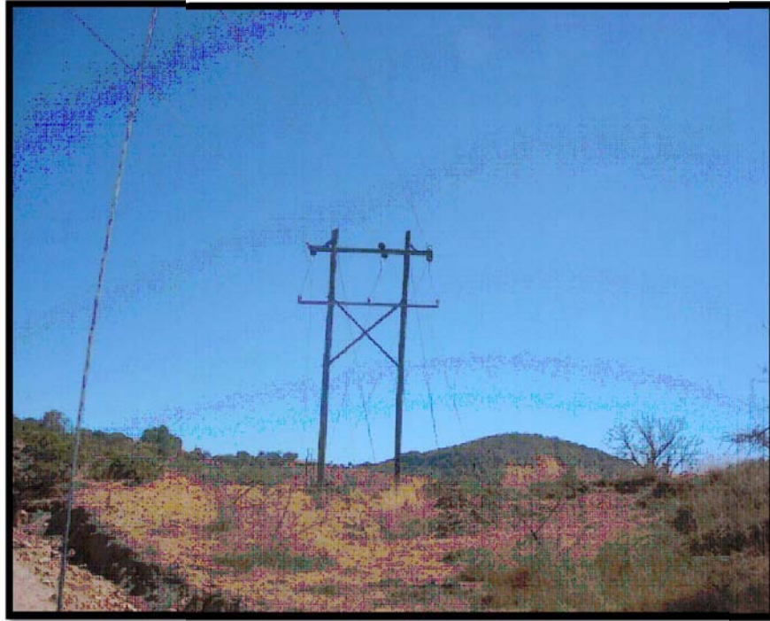
Fig. II. D Se observa del lado derecho del camino el Tendido Eléctrico
