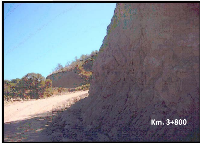
Fig. II.I Se observa que el kilometro 3+800 las medidas del Camino existente no son las requeridas, se requerirán de cortes de lado derecho.
