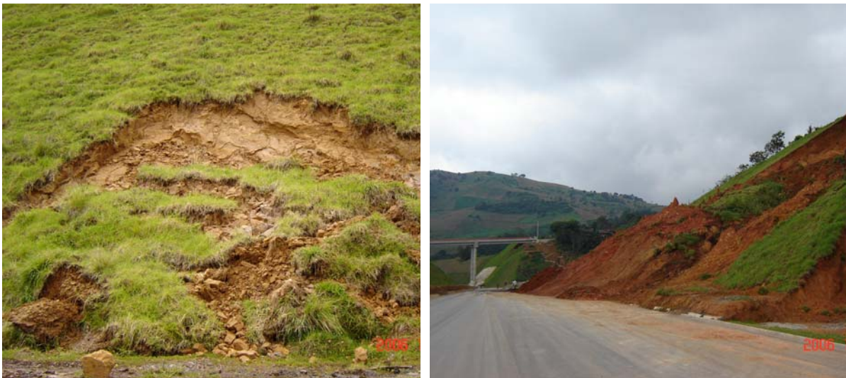
Fotos V.5.- Derrumbes de material en cortes ocurridos en tramos anteriores de la autopista México-Tuxpan.
