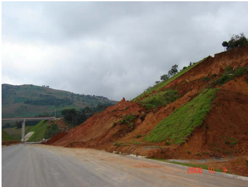
Foto VI.2.- Vista de un corte con derrumbe en un tramo anterior al sujeto al presente estudio.
