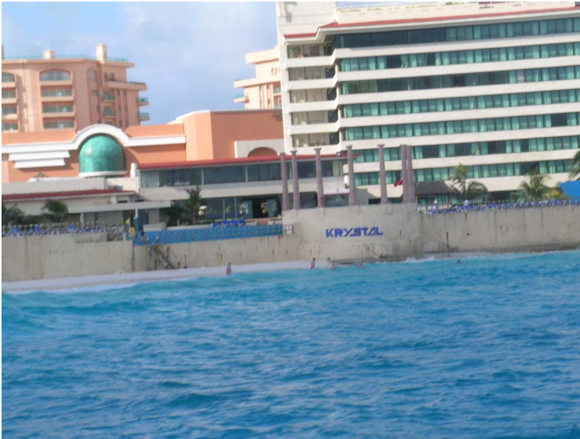
Figura IV.4 Hotel Krystal sin playa, el oleaje impacta directamente en la barda.
