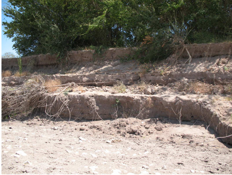
Figura 3.- Muestra el problema de socavamiento de la ribera del río Quelite.
