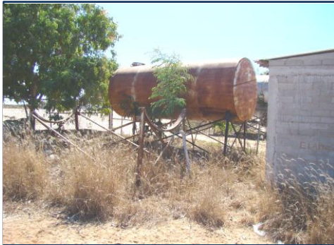
Tanque de Almacenamiento de Combustible Existente
