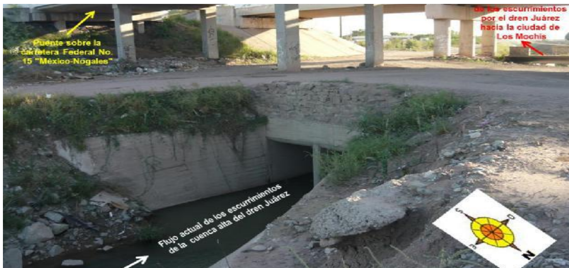
Fotografía 1.- Flujo actual del dren Juárez hacia la ciudad de Los Mochis a la altura de la Carretera Federal 15 México-Nogales, cuya alcantarilla que se observa, se pretende sellarse para desviar las aguas hacia el dren Bayoneta-Cerrillos y Buenaventura.
