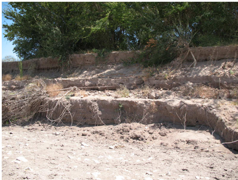
Figura 3.- Muestra el problema de socavamiento de la ribera
