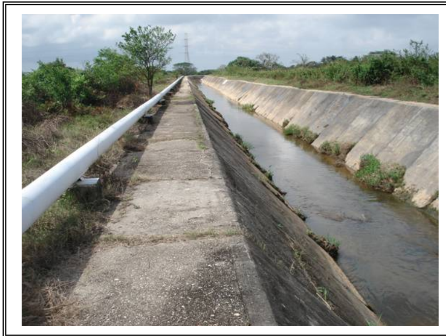
MF-17: Cruce con Canal de efluentes proveniente del Complejo Cangrejera en el km 10+780.00
