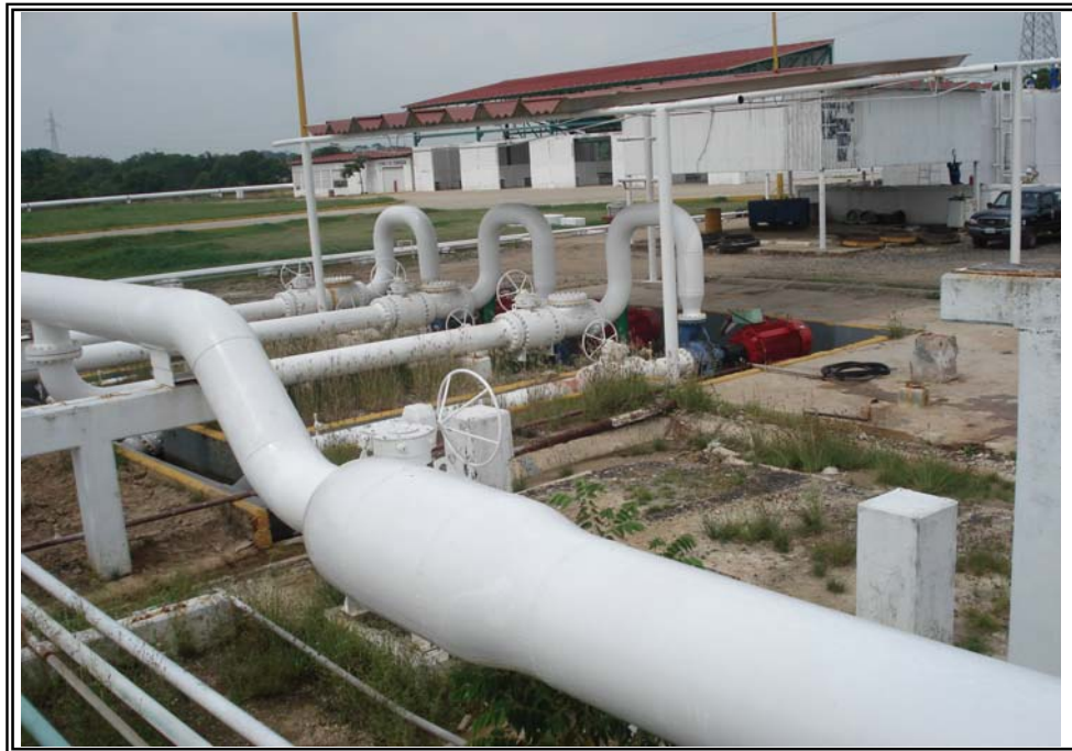
MF-01: Casa de bombas del Centro de Almacenamiento Estratégico Domos Salinos Tuzandépetl, lugar donde se instalará el sistema de bombeo que succionará salmuera de la Presa C para alimentar al Salinoducto.
