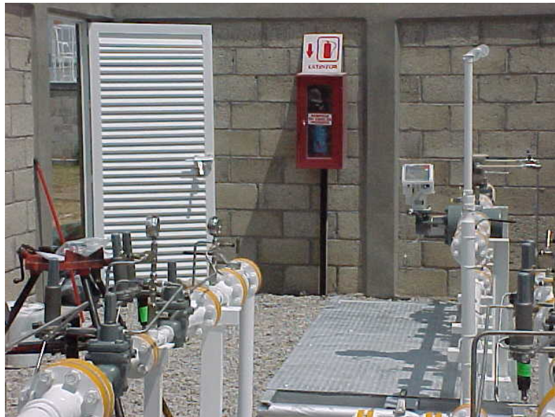
Extintor tipo PQS en caseta de medición y regulación (Interconexión)
