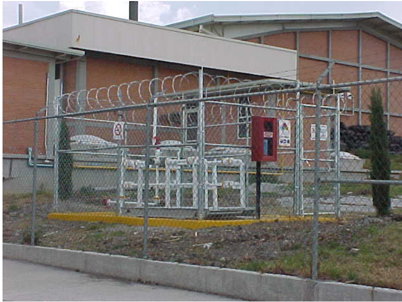
Extintor tipo PQS en caseta de medición y regulación (Usuario)
