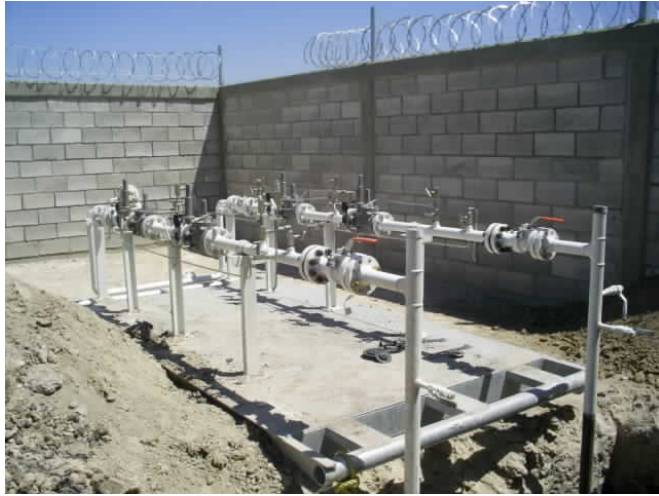
Conexión del patín de regulación en la caseta del punto de interconexión.
