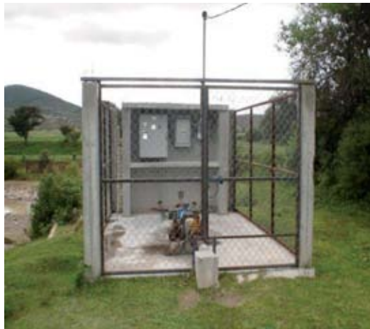
Pozo de abastecimiento de agua potable.
