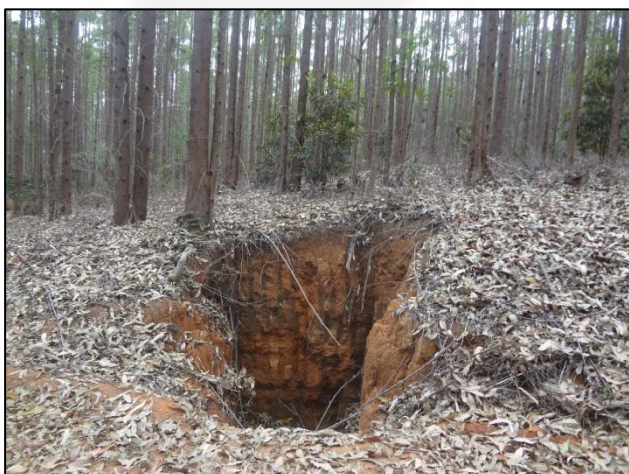
Foto 07 – Caixa seca às margens de via de acesso – Fazenda Santa Cruz.
