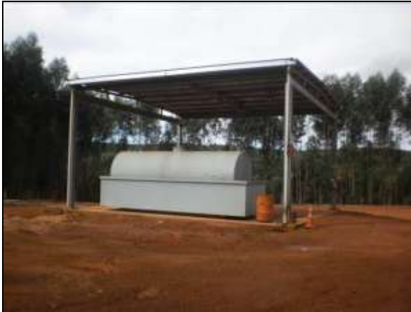
Foto 07: Tanque de combustível
