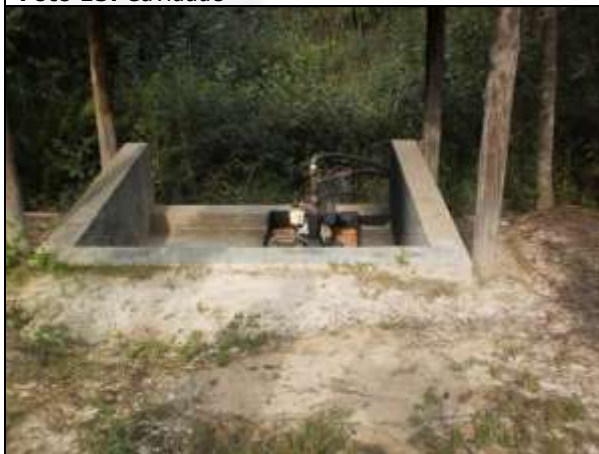
Foto 17: Ponto de Captação de água
