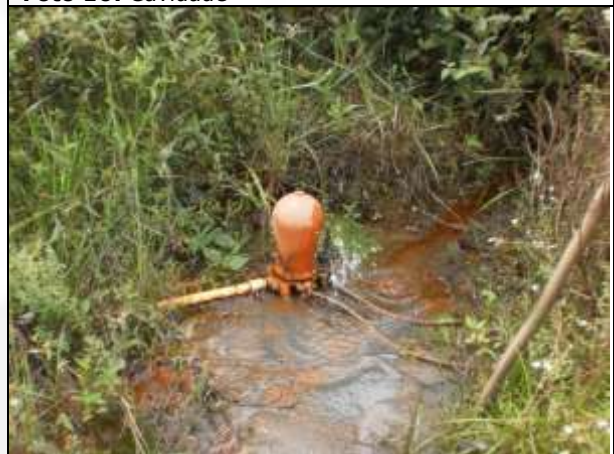
Foto 18: Ponto de Captação de água
