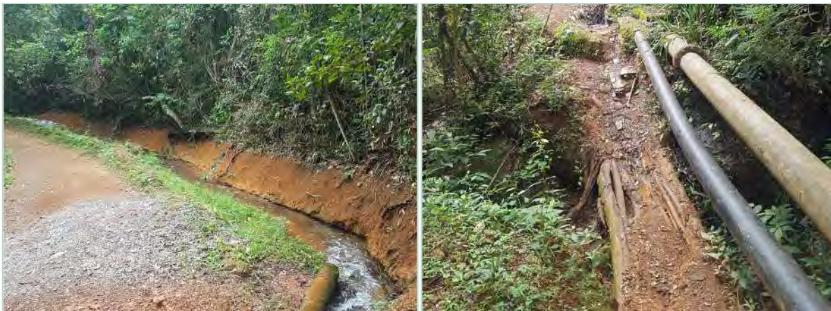
Figura 3.41 Trechos canalizados de cursos-d'água afluentes da margem direita do ribeirão Sabará no interior da área de estudo.
