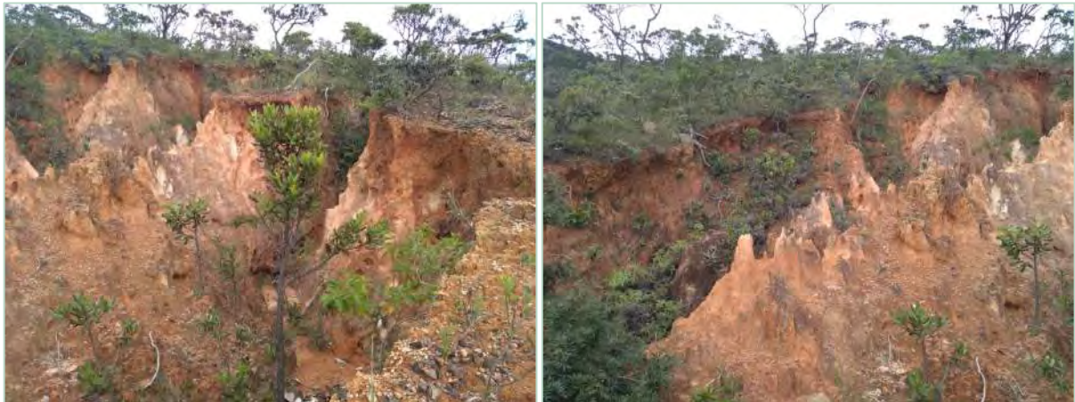
Figura 3.34 Registros de erosão em área de média erodibilidade no MF34.
