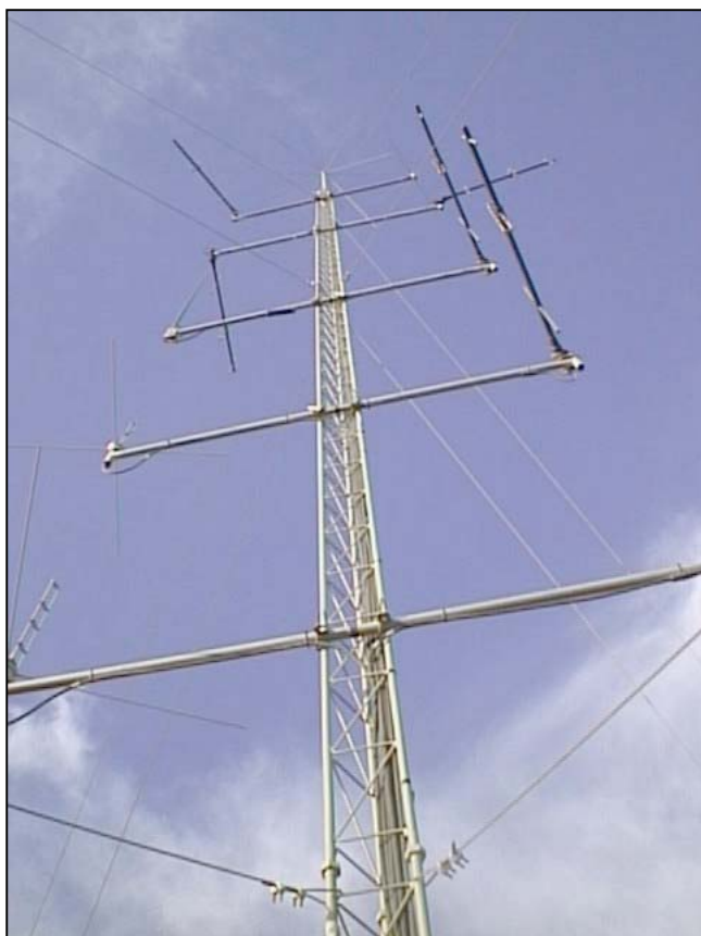
Mástil de antenas
