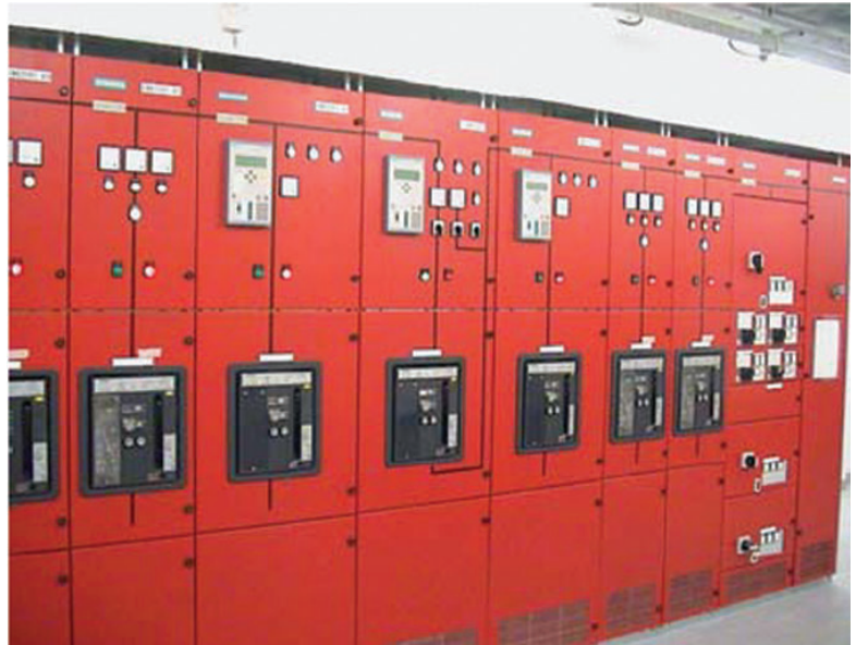
Bild 1 SIVACON 400 V, mit 7SJ62 geschützte und gesteuerte Leistungsschalter
