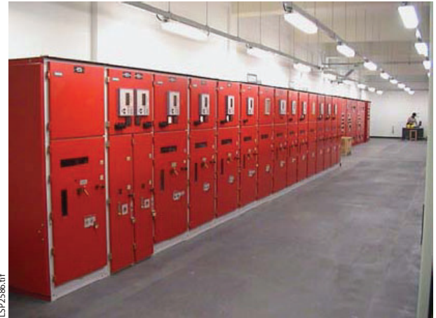
Bild 8 8BK Luftisolierte Schaltanlage 6,6 kV, mit 7SJ63 geschützte und gesteuerte Leistungsschalter
