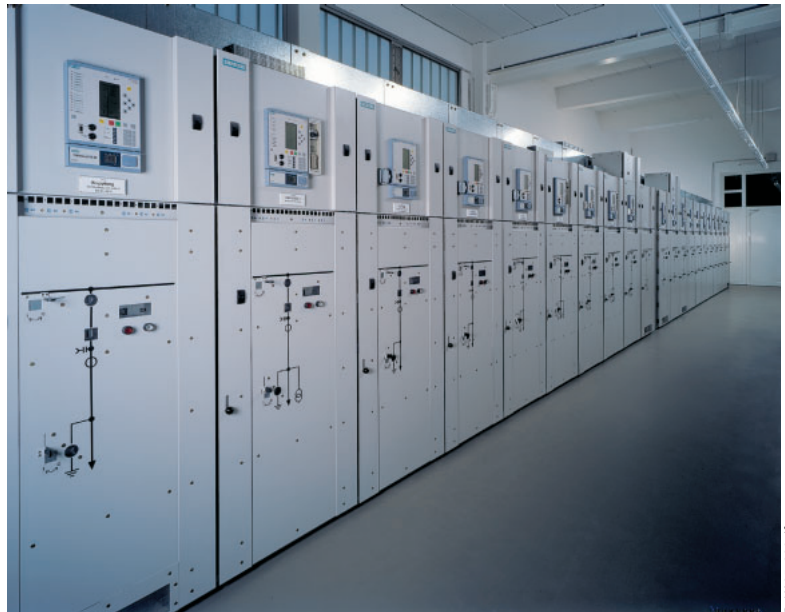
Bild 1 Mittelspannungsschutz mit SIPROTEC-Geräten
