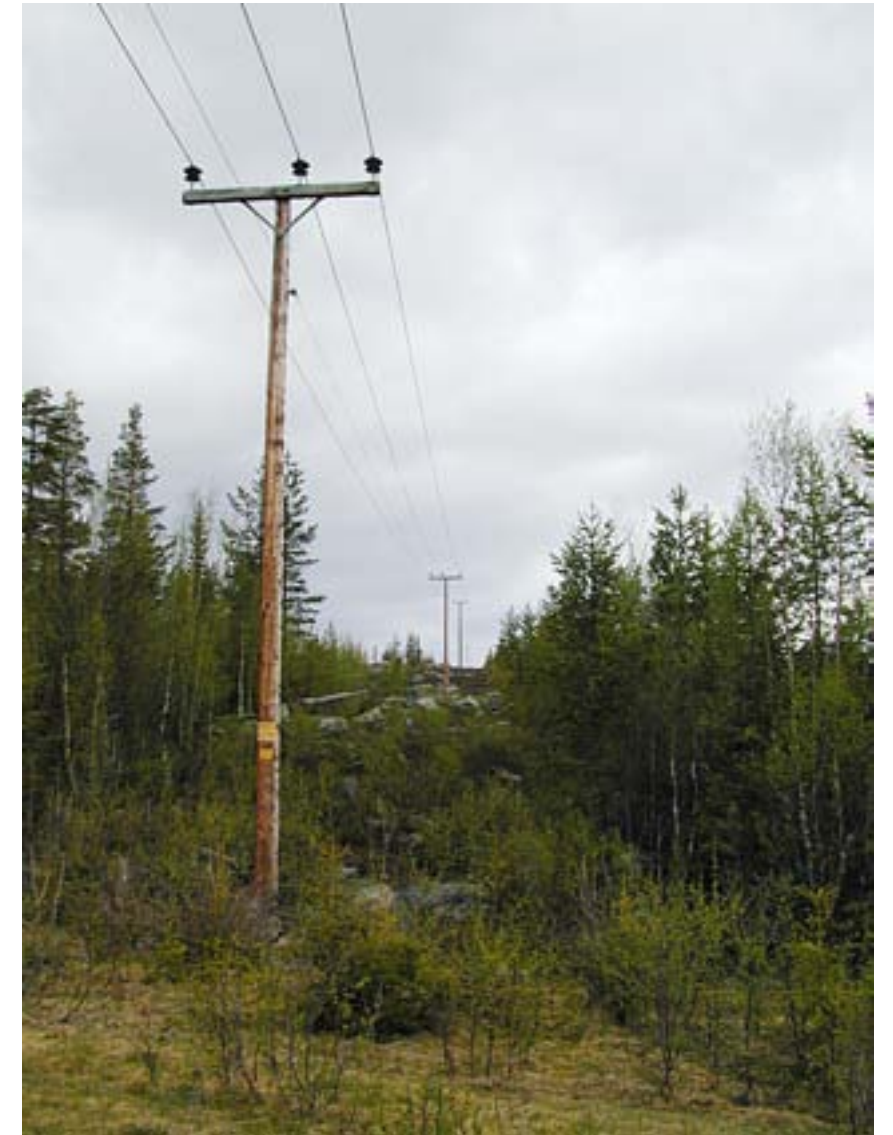
Härjeåns regional nät (20 och 40 kV). Begränsad överföringskapacitet
