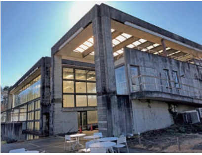
図15 再整備前の外観 壁が黒ずんだ温室。
