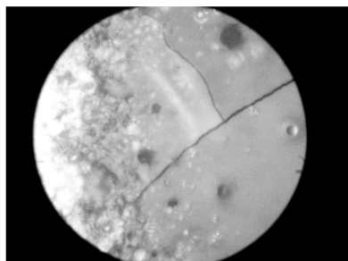
3.h ábra Felszíni rétegen megjelenő hajszálrepedés
