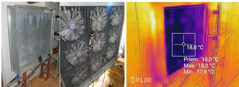
Obr. ch1: Vľavo je obrázok výmenníka tepla pre chladenie domu studňovou vodou, ktorého účinnosť bola zvýšená pridaním ventilátorov – obrázok v strede. Termovízia výmenníka – chladenia studňovou vodou je na obrázku vpravo.
