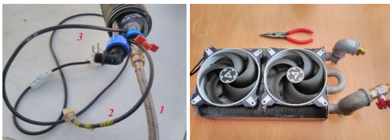
Obr. m1: Vľavo – Ochrana voči zamrznutiu prívodu vody do maringotky (1 – prívod vody, 2 – ethernetový kábel pre internet, 3 – napájací kábel vyhrievania) Vpravo – tepelný výmenník chladenia – vrchný pohľad
