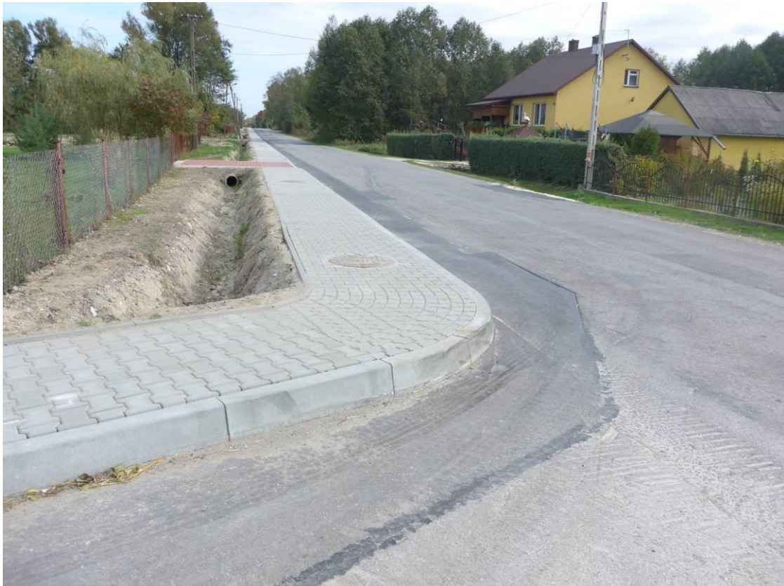
Zdjęcie 36 Chodnik w miejscowości Łany.
