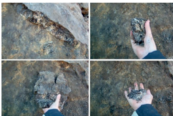
Figure 5 : Fantôme de roche d'aspect sableux et friable. La photo est prise dans une excavation pour assise d'éolienne (Beaumont).
