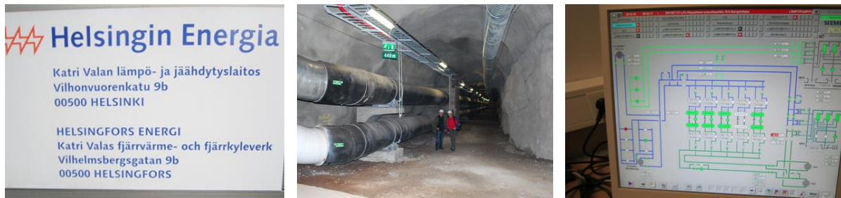
Slika 14: 400MW toplotno črpalni sistem v Helsinkih.
