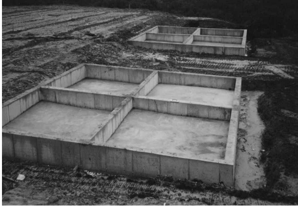
Abb. 2.3 Betonwannen (Einbau 1998; Foto Kadelka, BFUB)
