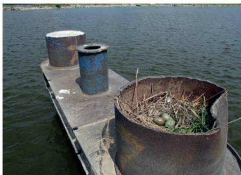
Un nid avec des œufs sur un élément de structure de l'embarcadère du ferry sur la Vistule
