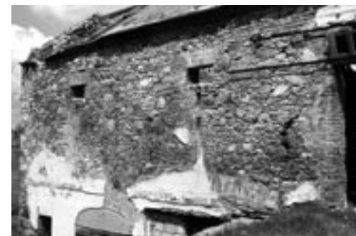
Abb.: Viele böhmische Dörfer des Erzgebirges wurden dem Erdboden gleichgemacht - und auch etliche der verbliebenen Häuser (hier in Fojtovice) bieten ein trauriges Bild.
