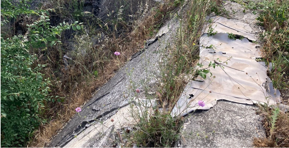
Fig. 3. The rubber sheets that waterproofed the basin and lined the banks are now engulfed and fragmented. / I teloni in gomma che impermeabilizzavano il vascone e rivestivano gli argini sono ora deformati e frammentati.
