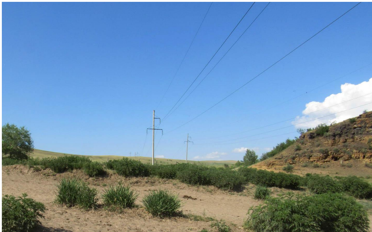
Рис. 84. Двухцепная ВЛ 110 кВ С-93/С-94 ПС «Минусинская опорная» - ПС
