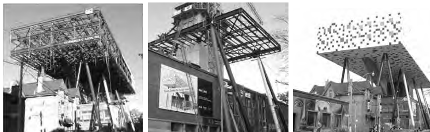
Εικ10 Ontario College of Art and Design, Alsop Architects και Robbie/Young + Wright. Φάσεις κατασκευής και τελικό αποτέλεσμα.
