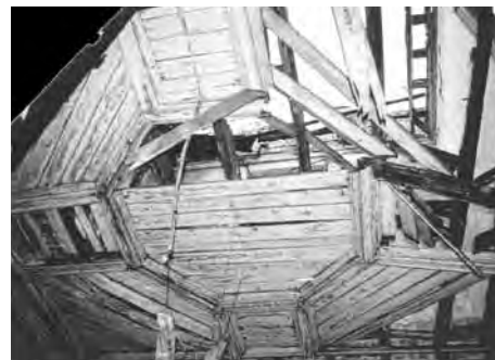
Εικ. 2 Ορατή η εσωτερική δομή λόγω μερικής κατάρρευσης του πατώματος.
