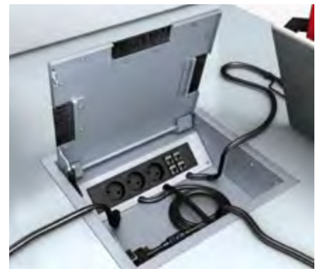
Hinter der Techniklappe verbergen sich 4 VGA/ Audio Anschlusskabel. Einschussfeld stellt Strom und Netzwerkanschlüsse zur Verfügung.
