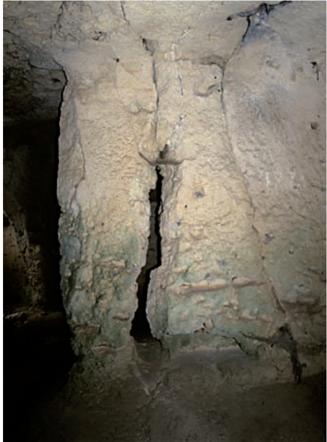
Fig. 9 – Pilastro di sostegno all'interno di una cavità artificiale nella Gravina di Petruscio, in territorio di Mottola: la stabilità è seriamente compromessa dalle fratture beanti che interessano il pilastro e la volta della cavità.
