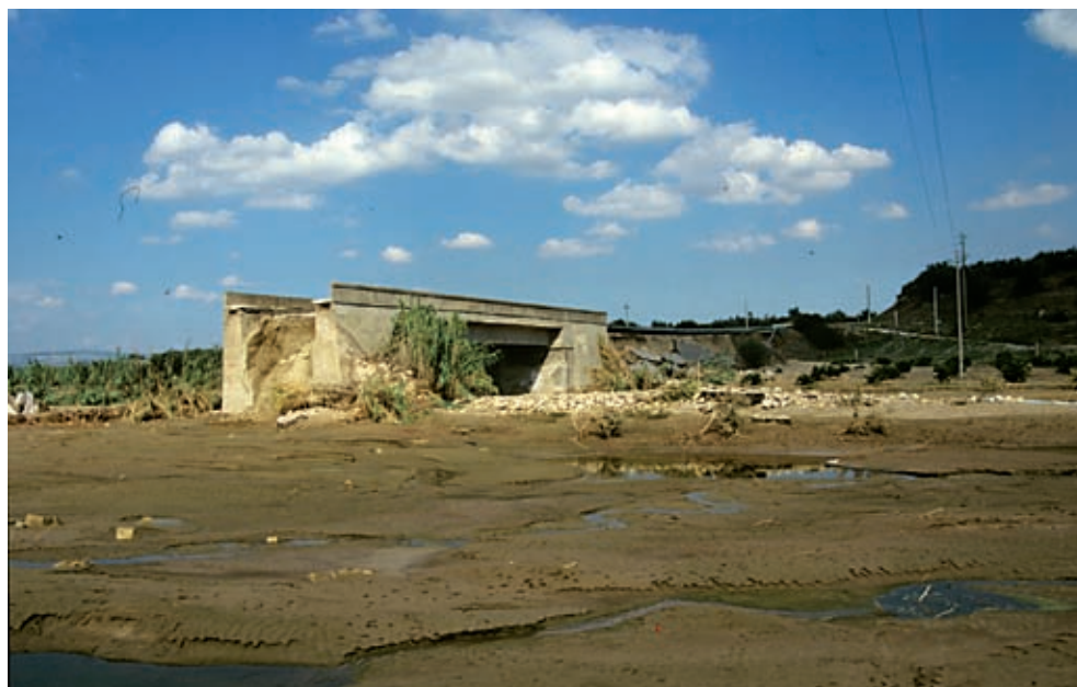
Fig. 6b – Effetti dell'alluvione del settembre 2003 nel territorio della provincia tarantina: ponte asportato dal passaggio della piena, qualche centinaio di metri a valle dello sbocco di una gravina.
