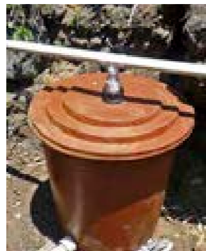
Filtro vertical conectado a dos salidas de aguas grises.
