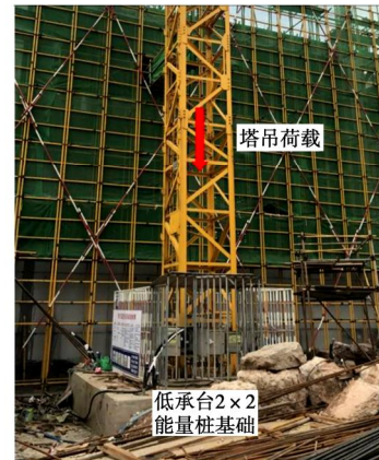
(a) 塔吊实物图
