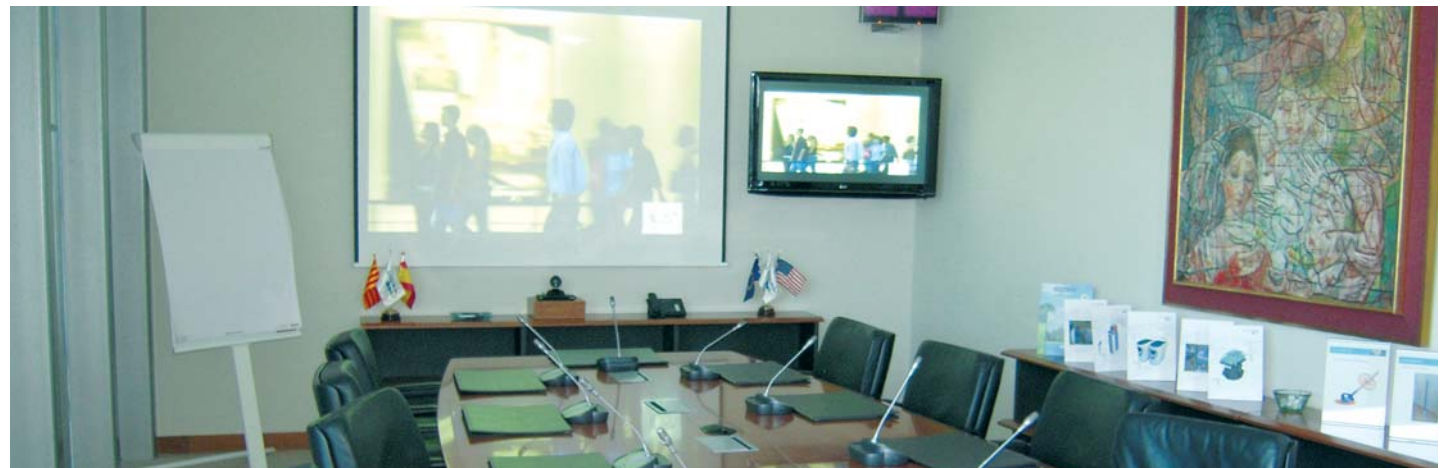
Control global en salas de juntas centralizado en consola
