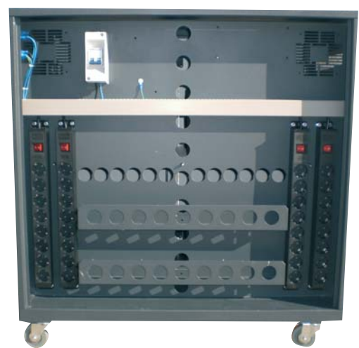
Instalación eléctrica dedicada, con acceso restringido, bandejas para los cargadores con cierre de llave
