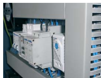
Ventiladores y carga secuencial en dos circuitos, con termostato y reloj
