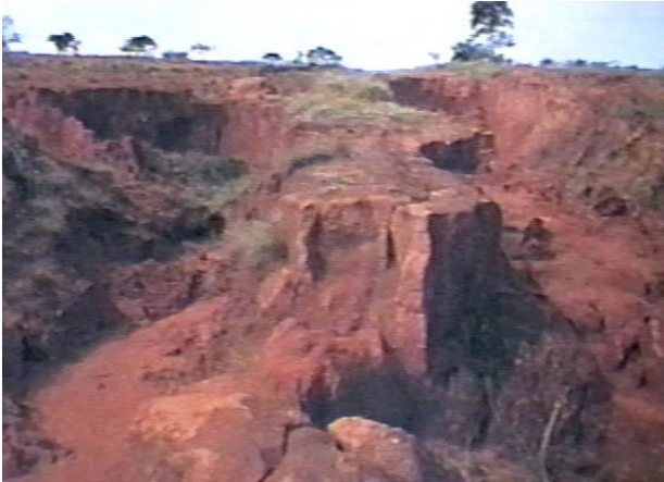
Figura 35. Erosão Foto: Scapin
