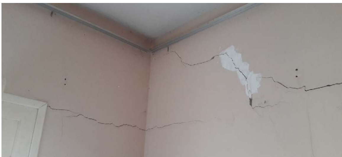
casa do reassentamento construído em 2005, desocupada há 02 anos por conta das rachaduras
