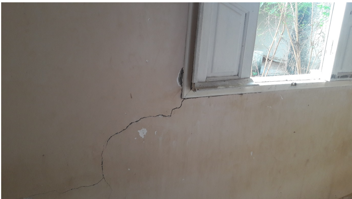
casa do reassentamento construído em 2005, desocupada há 02 anos por conta das rachaduras
