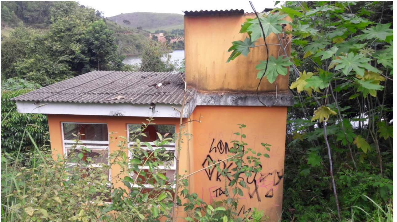
ESTAÇÃO DE TRATAMENTO DE ESGOTO – ETE INOPERANTE
