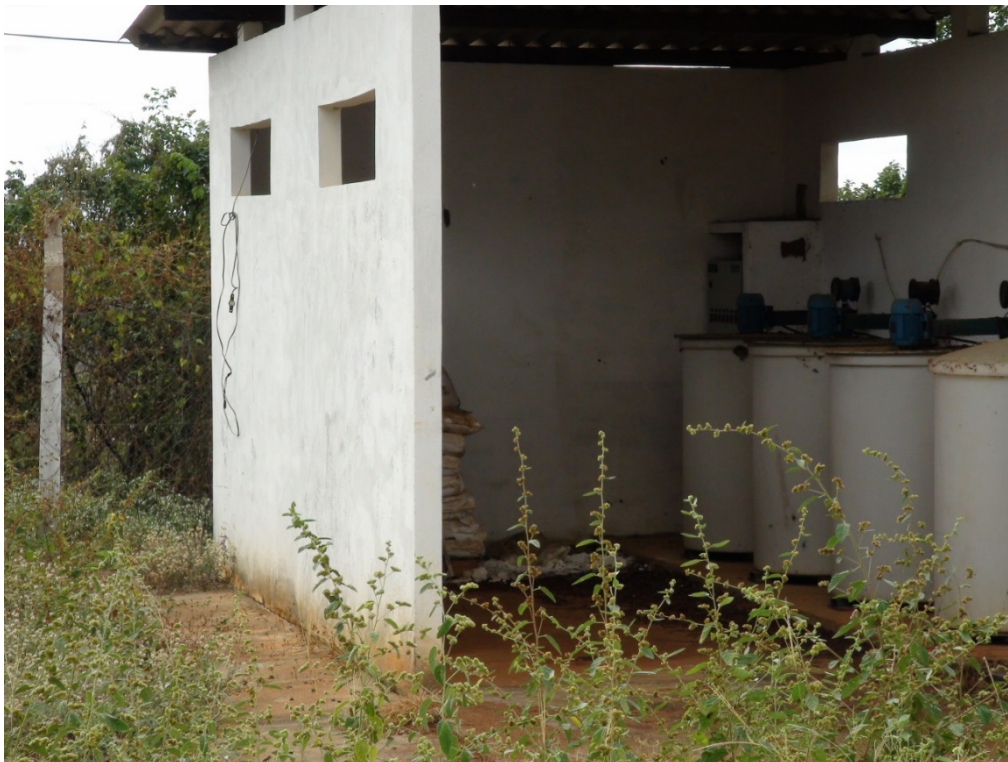
ESTAÇÃO DE TRATAMENTO DE ÁGUA. MATERIAL DETERIORANDO
