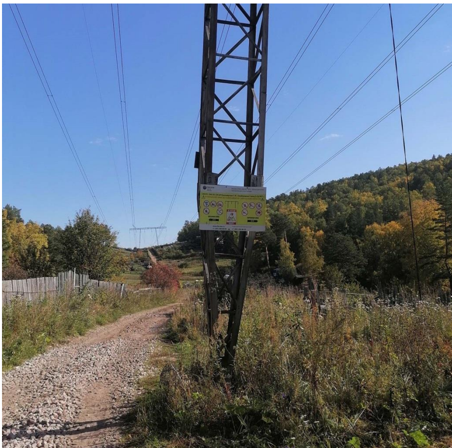
Рис. 4.39 ВЛ 220 кВ КГЭС - ПС "Левобережная", проходящая по СНТ "Родничок-2". Фото Антонов О.М.
