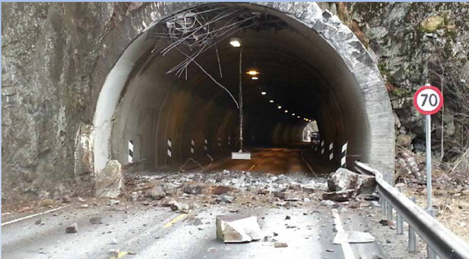
Vaksdal isolert etter to nye ras (04.2013)
