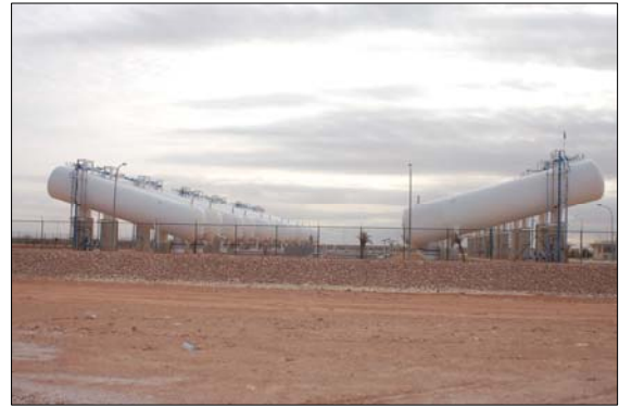
Abb. 6: Windkesselanlage an der Hauptleitung des Great-Man-Made-River-Projects bei Beni Walid
