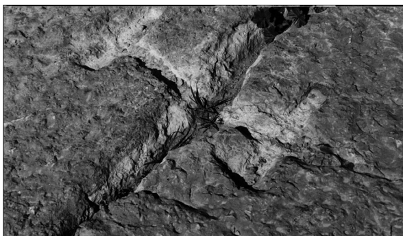
Σχ. 2. Έγκοιλο μορφής διπλού ταυ σκαλισμένο επάνω σε δύο δομικούς λίθους. Μέσα στο έγκοιλο είχε τοποθετηθεί σύνδεσμος ανάλογης μορφής (διπλού ταυ) που περιβάλλονταν με χυτό μολύβδο και συνέδεε οριζόντια τους δύο λίθους.
