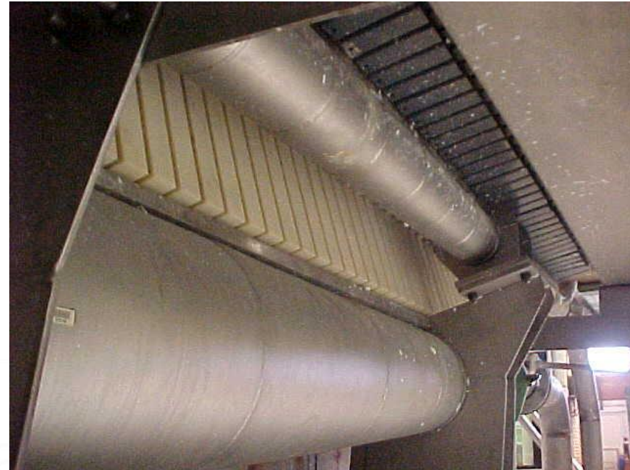
Modulo Jet (Profilmatic, Voith): correção automática do perfil transversal de g/m 2 .
